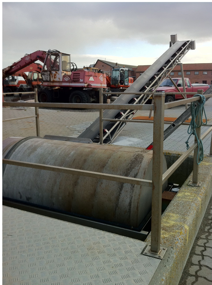
Figur 3. Transportbånd til fjernelse af affald i forbindelse med kompensationsmuslinger installeret på Vilsund Blue a/s i forbindelse med forsøg.
